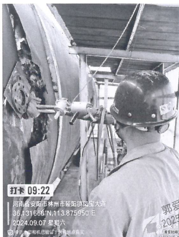
烧结机头排气筒出口（本排出口与4季度比对检测因子按频次交叉检测）
